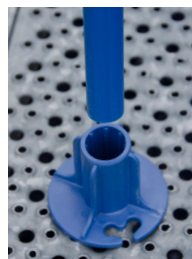
Trykk avlaster-rør i bunn av sokkel.
